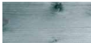
Unbehandelte Oberfläche Folge: Holz vergraut vollflächig
